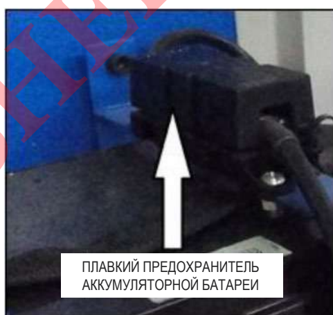
Рис. 13. ПЛАВКИЙ ПРЕДОХРАНИТЕЛЬ АККУМУЛЯТОРНОЙ БАТАРЕИ
